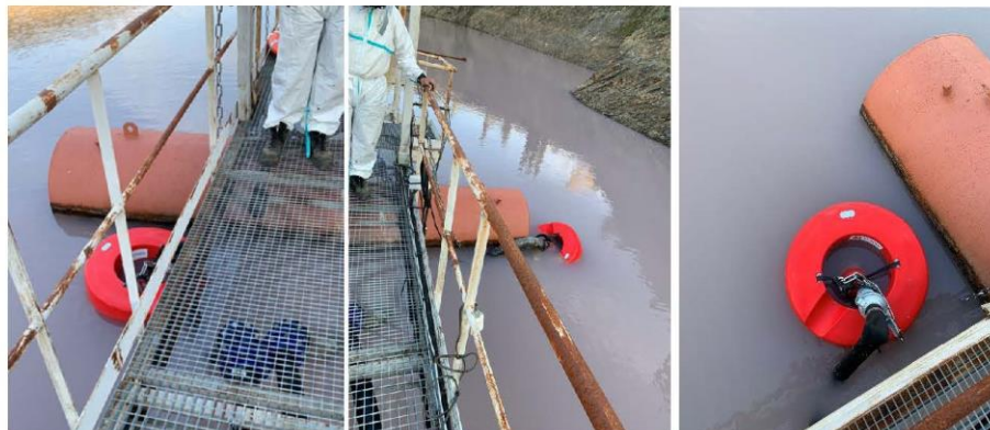
FIGURE 3: BOUEES ET POMPES DU BASSIN 6 DE L'ARTUS
